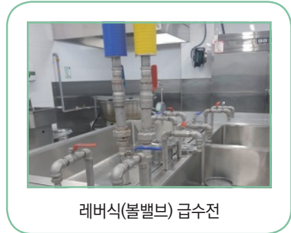
관리가 용이한 천장 배관 급수시설
